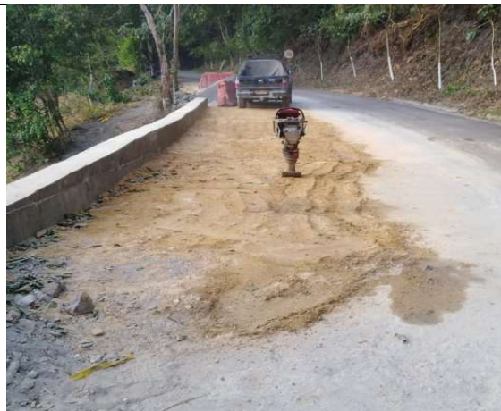
10. después perdida de banca en la vía Nocaima - Nimaima
