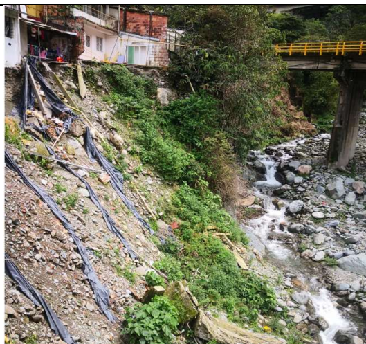
11 antes afectaciones viviendas Municipio Guayabetal
